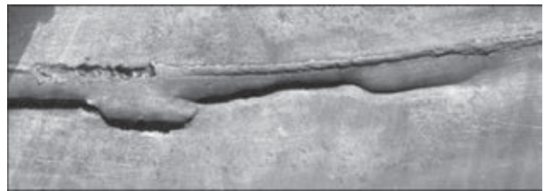
Рис. 9. Внутренняя поверхность трубы в зоне повреждения
