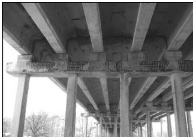
Рис. 1. Общий вид железобетонных конструкций автодорожного моста после 19 лет эксплуатации
