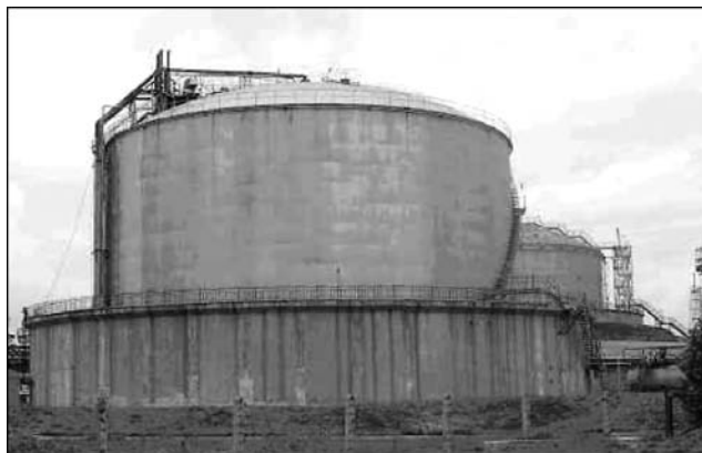
Рис. 1. Общий вид сварного резервуара для хранения жидкого аммиака
