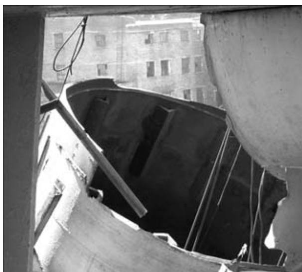
Рис. 3. Общий вид разрыва несущей трубы моста
