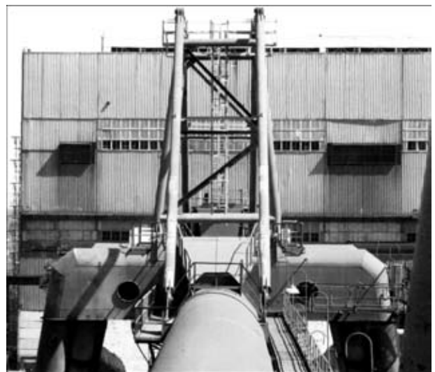
Рис. 12. Общий вид шпренгельной системы усиления на одной из опор крана-перегрузателя
