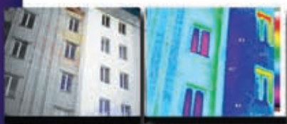
Видимое и тепловое изображение фасада жилого здания
