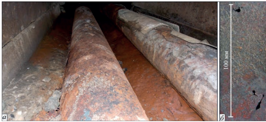
Рис. 1. Подавальний і зворотний трубопроводи в непрохідному каналі (а); наскрізні корозійні пошкодження подавального трубопроводу (б)
