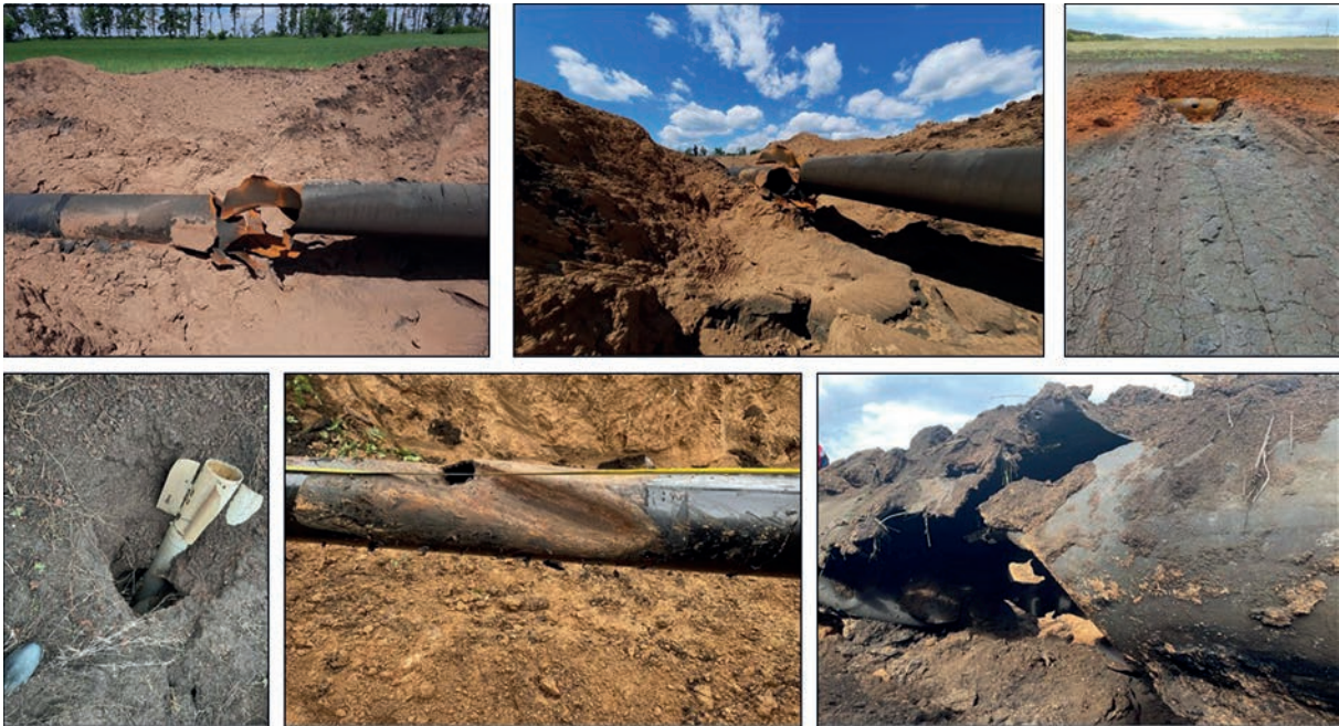
Рис. 1. Пошкоджені трубопроводи внаслідок воєнних дій
