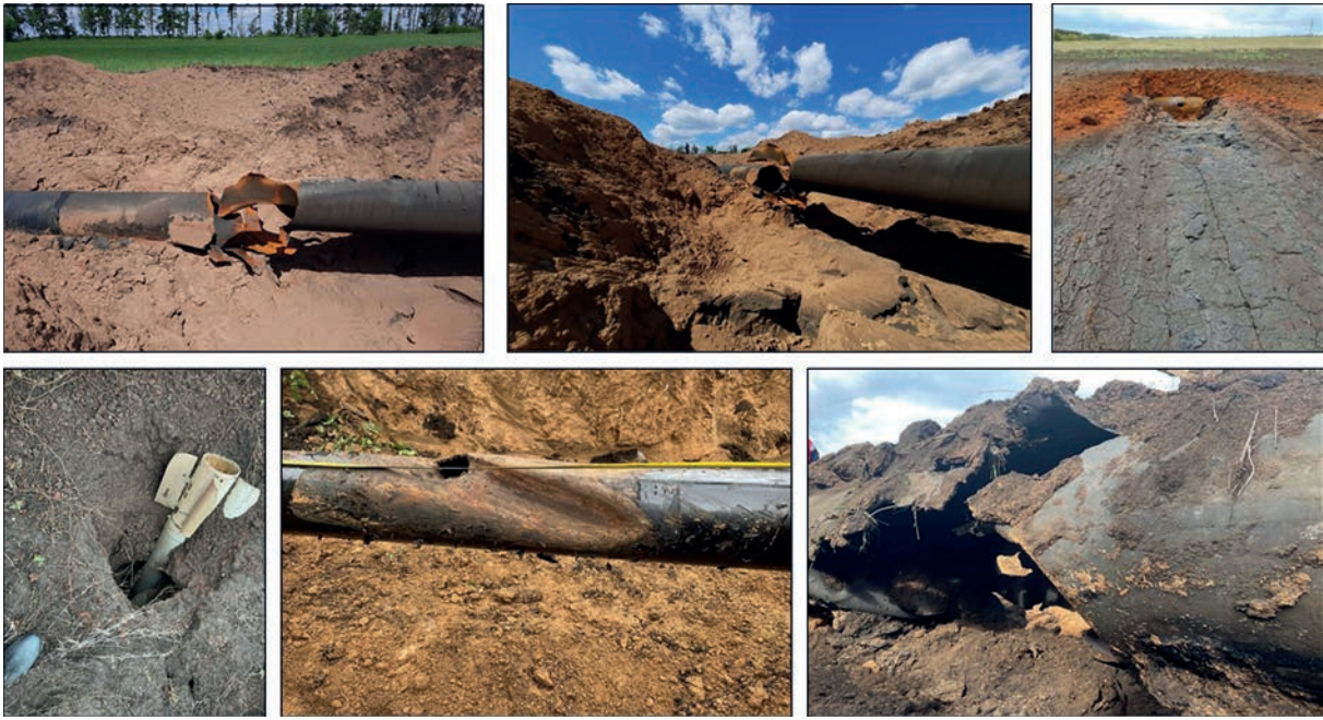
Рис. 1. Пошкоджені трубопроводи внаслідок воєнних дій
