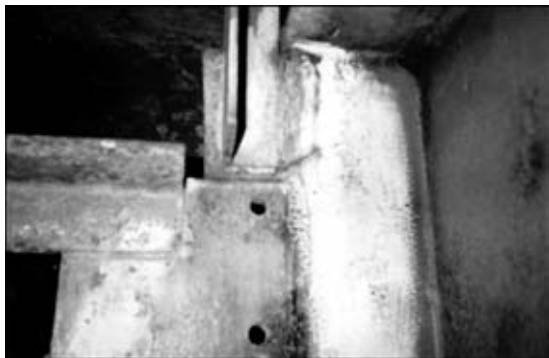
Рис. 6. Вид усталостной трещины в узле крепления подвески Паркового пешеходного моста на Труханов остров, в котором при ремонте не выдержано расстояние между фланговыми и лобовыми швами
