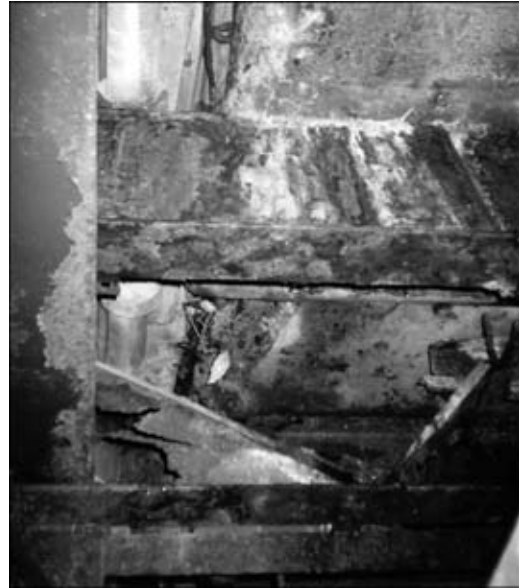
Рис. 3. Вид коррозионного повреждения поперечных балок моста им. Е. О. Патона
