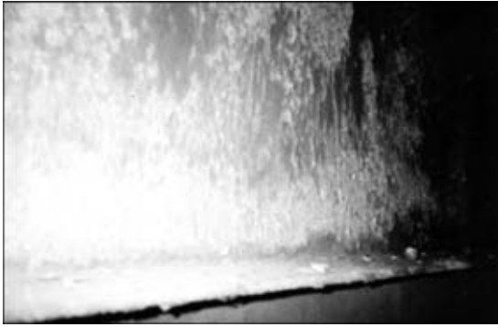
Рис. 1. Вид коррозионного повреждения на участке стенок главных балок моста им. Е. О. Патона
