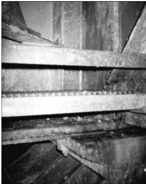
Рис. 2. Вид коррозионных повреждений поясов, ребер главных балок и элементов связей в надопорных участках пролетного строения моста им. Е. О. Патона
