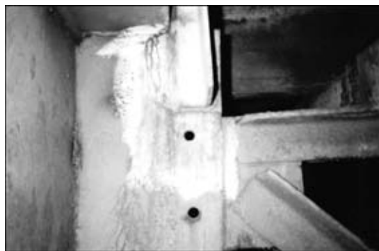
Рис. 7. Вид продольной трещины в фланговом угловом шве крепления подвески к вертикальному ребру на стенке главной балки Паркового пешеходного моста на Труханов остров
