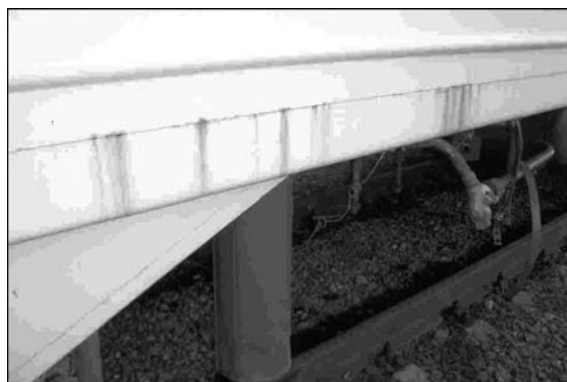
Рис. 2. Вид вагона с дефектами сварного шва, возникшими в процессе его эксплуатации
