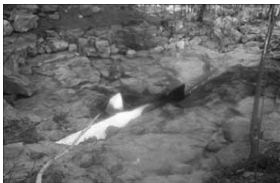
Рис. 2. Общий вид разрушения магистрального газопровода Бэргэ-Якутск
