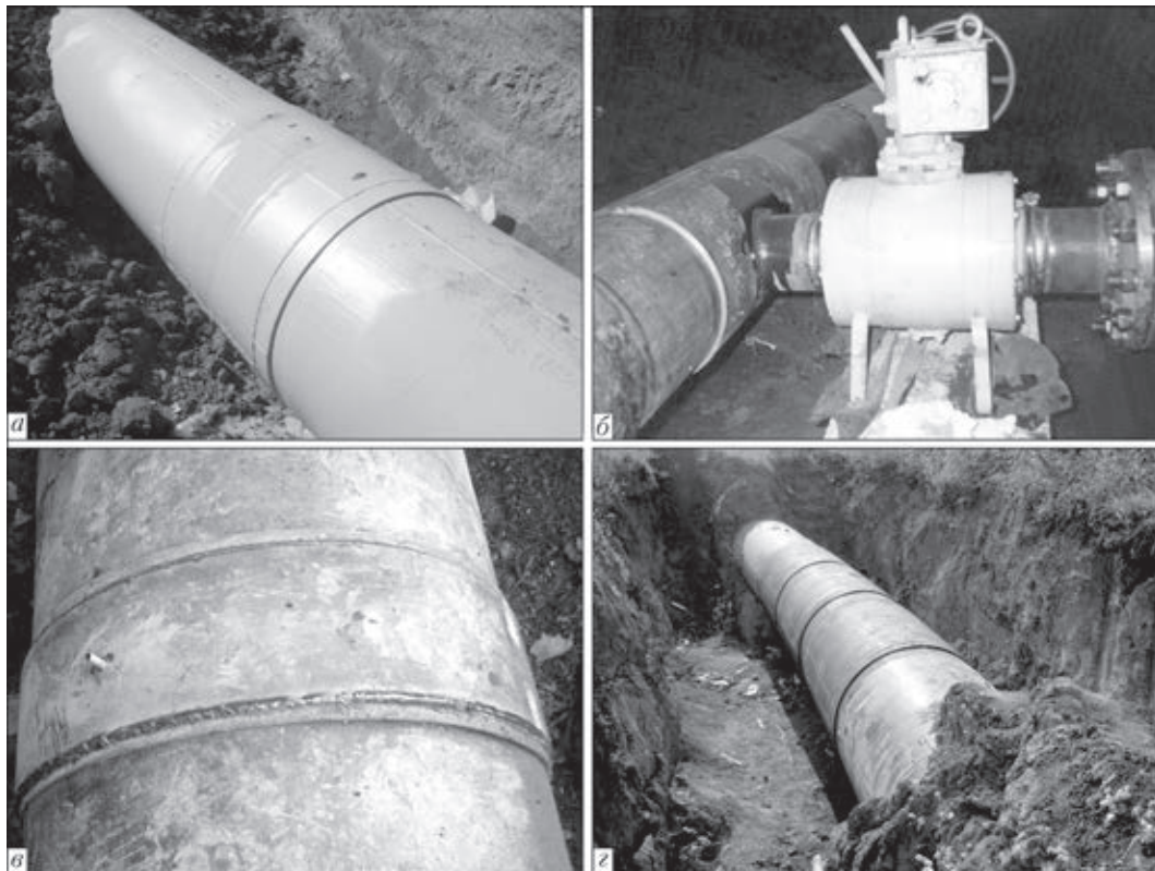
Рис. 10. Установка на МТ: герметичной муфты (а), отвода (б), двухслойной муфты (в) и клеесварных муфт (г)
