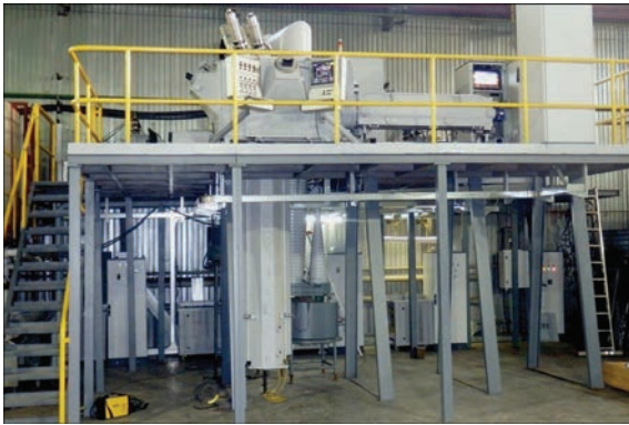
Рис. 8. Общий вид установки L-4
