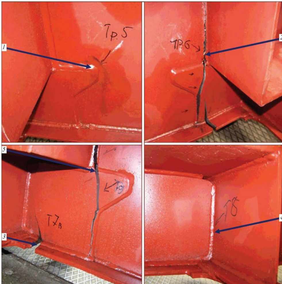
Рис. 4. Трещины в шкворневом узле (образец № 4): 1 — трещина T5; 2 — T6; 3 — T7; 4 — T8; 5 — T9 по другую сторону от хребтовой балки от трещины T6
