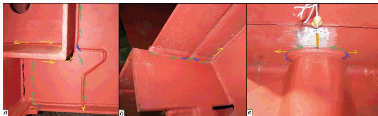
Рис. 6. Развитие трещин: а — в шкворневом узле; б, в — в узле заделки стойки боковой стены
