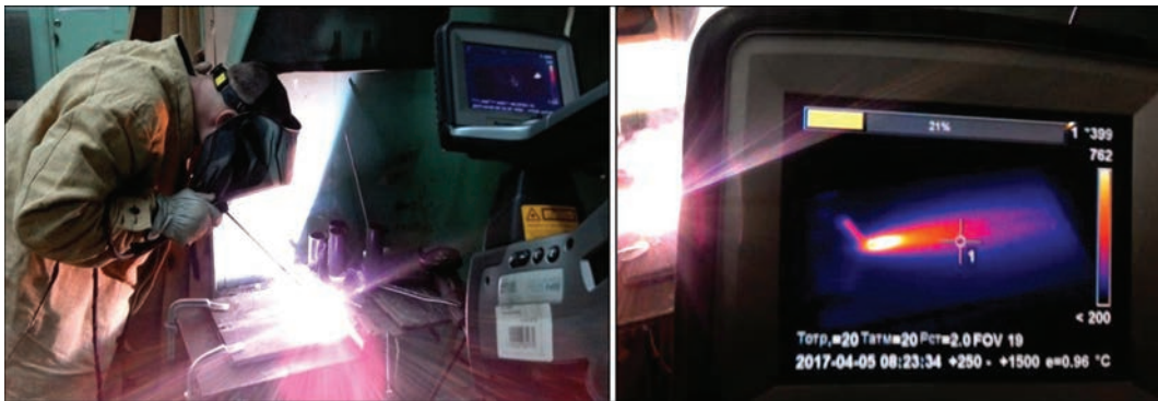
Рис. 9. Тепловизионная съемка температурных полей на поверхности пластины при сварке в нижнем положении
