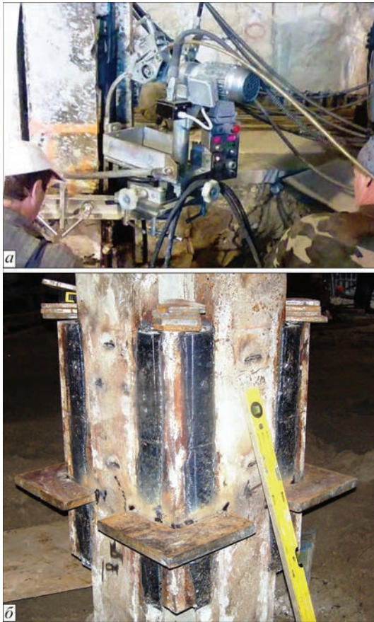
Рис. 7. Фрагмент электрошлаковой сварки плавящимся мундштуком усиленный проемов строительных колонн с использованием аппаратов АШП 113М2 (а) и внешний вид сварных швов (б)
