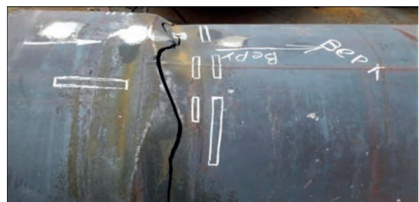
Рис. 1. Фрагмент демонтованої труби з ділянкою руйнування і позначками для вирізки темплетів для досліджень і механічних випробувань
