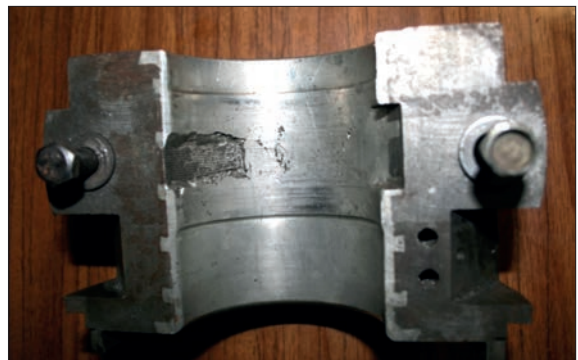
Рис. 3. Вкладиш підшипника живильного насосу ТЕЦ до ремонту
