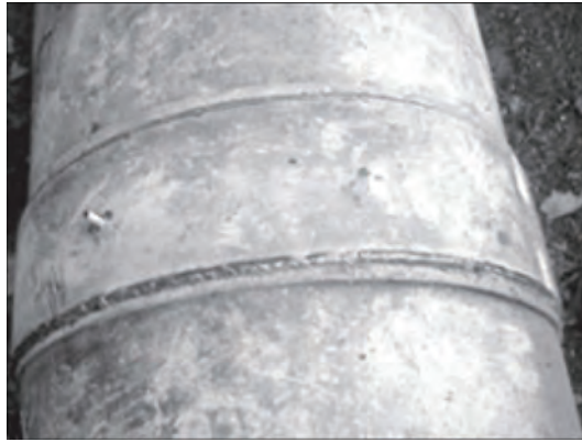
Рис. 6.3. Приклад дефектної ділянки трубопроводу, відновленої встановленням муфти з наповнювачем
