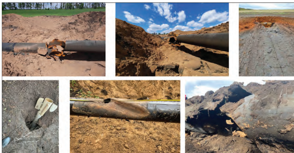
Рис. 1.3. Трубопроводи, пошкоджені внаслідок воєнних дій
