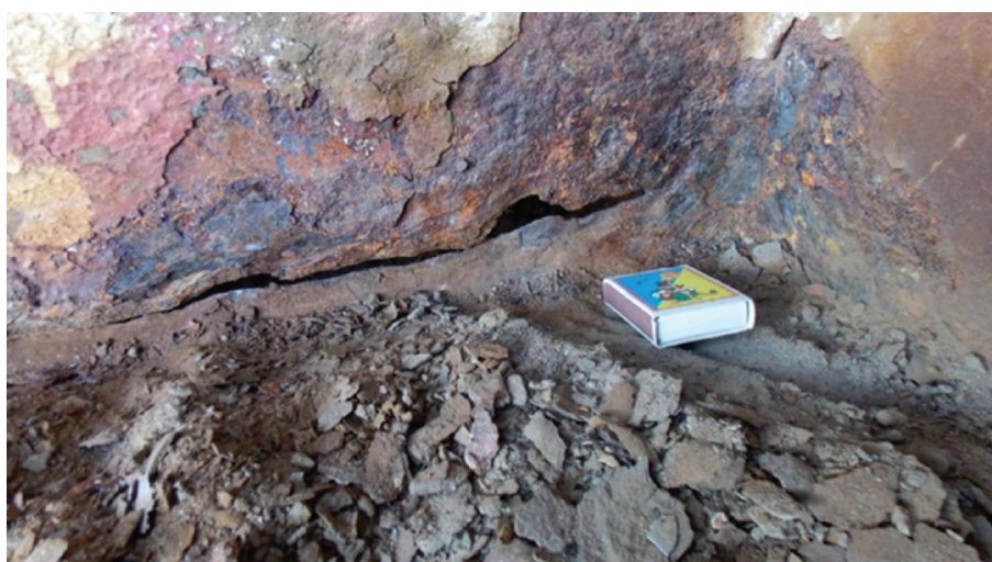
Рис. 3. Тріщина, що утворилась в зоні корозійного потоншення зварного шва ферми Ф46 головної балки № 4
