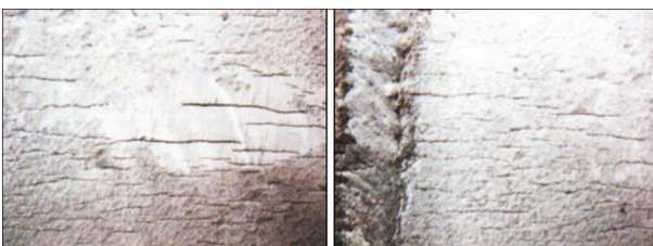
Рис. 3. Характерний вигляд стрес-корозійних тріщин
