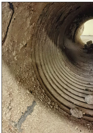
Рис. 1. Образец трубы большого диаметра бывшей в эксплуатации с отложениями значительной толщины на внутренней поверхности (фото представлено ООО «СПБГУ ДАЙНЭМИКС»)
