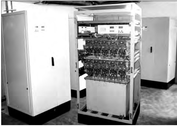
Рис. 5. Инверторные источники питания мощностью 500 кВт для питания электронных пушек установки ВТ02
