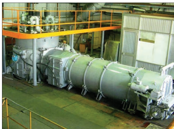
Рис. 5. Зовнішній вигляд промислової електронно-променевої установки УЕ-5812
