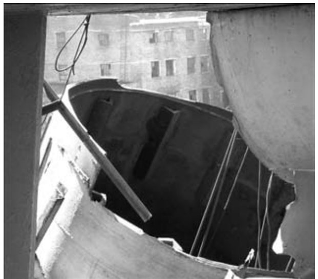
Рис. 3. Общий вид разрыва несущей трубы моста
