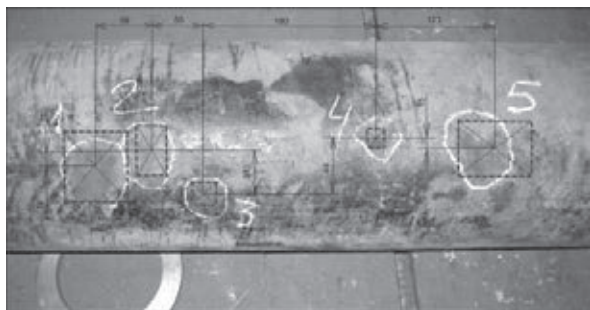
Рис. 1. Труба D273 с указанными расстояниями между дефектами – центрами пересечения диагоналей, очерченных вокруг них прямоугольников
