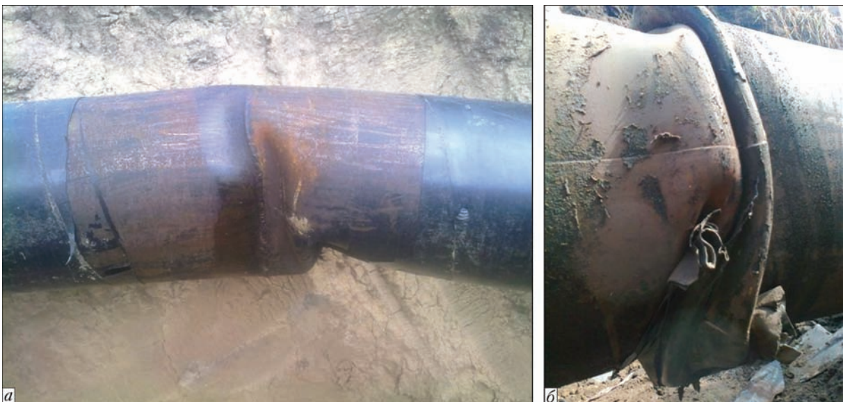
Рис. 1. Руйнування трубопроводів в зоні впливу шахтної виробки (опис а і б див. в тексті)
