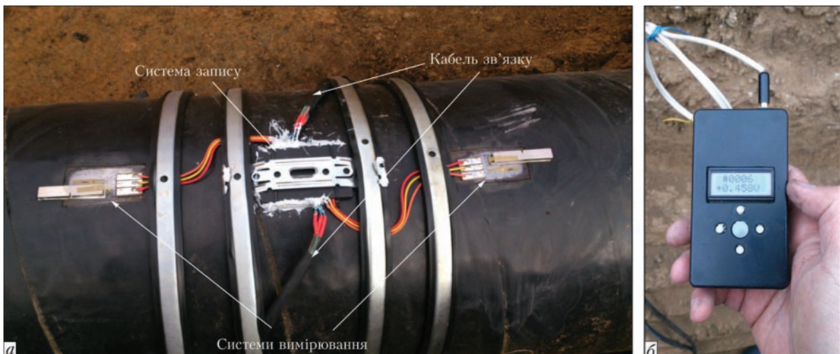
Рис. 4. Система моніторингу, що змонтована на трубопроводі (а) та дистанційний прилад для зчитування даних (б)
