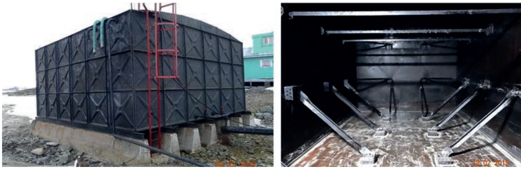
Рис. 2. Резервуар РГС-150. Вид зовні та зсередини
